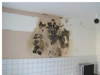
Verdeckte Schimmelbildung in einer Küche hinter Oberschränken wegen defekter Abwasserleitung
