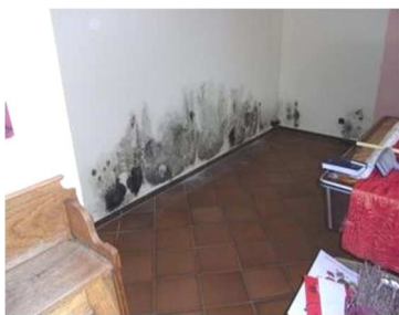
Schimmelbildung an einer Außenwand wegen defekter Kaltwasserleitung im Fußboden
